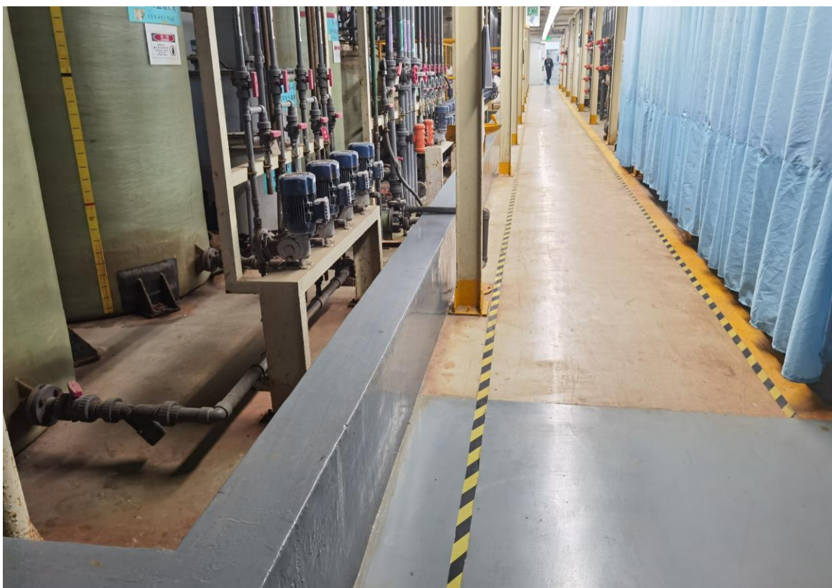
图 4-2 车间废水处理站现场图
