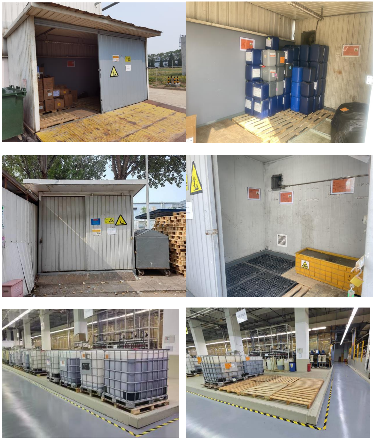
图 4-6 化镀危废库（上）综合危废库（中）化镀车间危废暂存区（下）现场图
