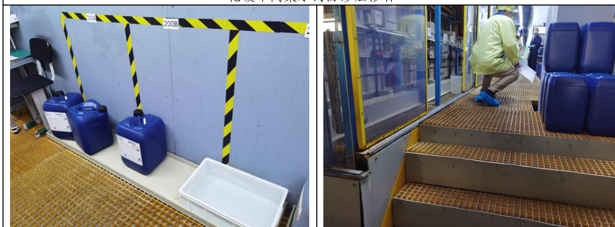
化镀线步道网格板更新，化镀线药水暂存区增加二次托盘
