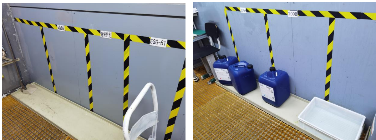
图 4-3 化镀线药水暂存区现场图
